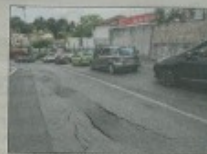
La chaussée affaissée de l'avenue Sidi-Brahim, rouverte depuis le 25 juillet. (Photo A. B.-I.)
